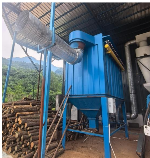
脉冲布袋除尘器（排气筒高度不足）
