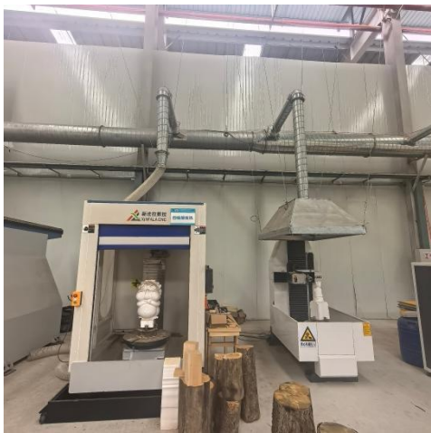
废气收集装置
